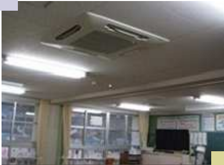
教室に設置されたエアコン (他市の事例)
